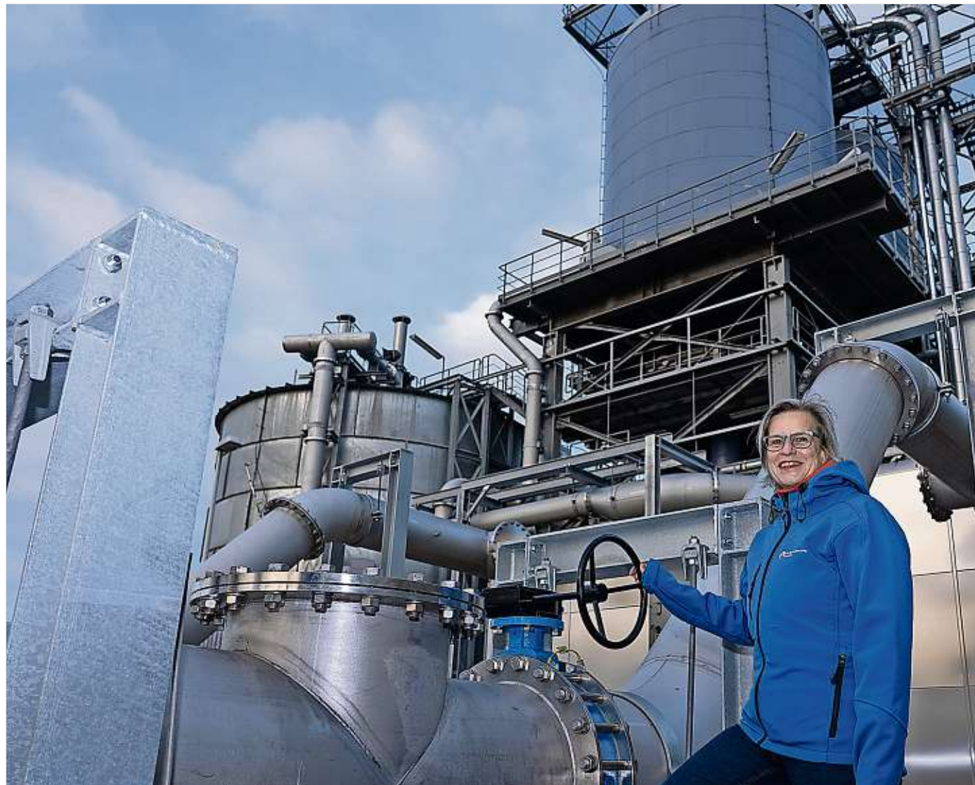
Projektleiterin Kirsten Bollrich vor der neu installierten Kompaktanlage, die Gerüche an der Schlammverladung mit einem chemisch-physikalischen Verfahren beseitigt. Sie ist froh, dass die Anlage endlich komplett ist.
