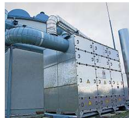
Diese bereits bewährte Filteranlage befindet sich am Rücklauf von der Schlammbehandlung zur biologischen Reinigung.
